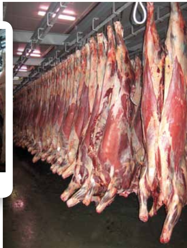
Kolejka rurowa w chłodni wołowej Pipe line system in the beef cold storage
