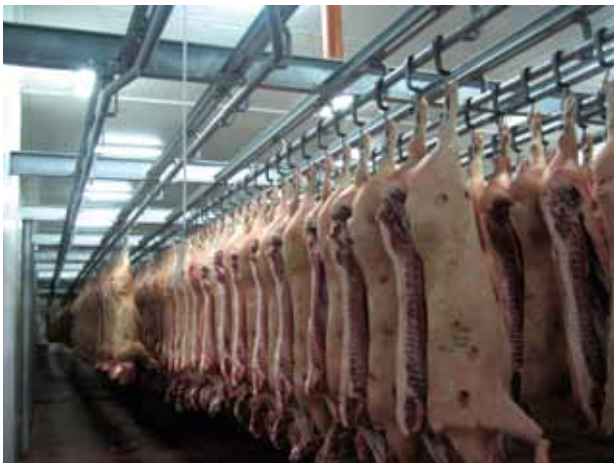
Kolejka rurowa w chłodni wieprzowej Pipe line system in the pork cold storage
